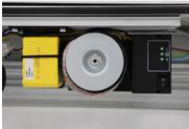
Transformador, baterías 24V Ni-Cd, interruptor de encendido-apagado
